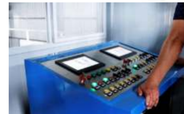
A 中心控制室 Central Control Room
